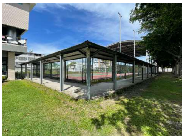
施工前 | 屋簷短、雨水沖刷造成兩側泥土流失
