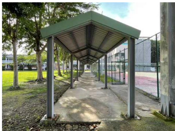
施工前 | 水泥地坪不平整積水
